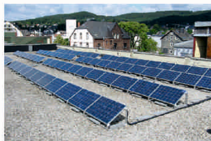
Das EnergieZentrum Balzer+Nassauer
